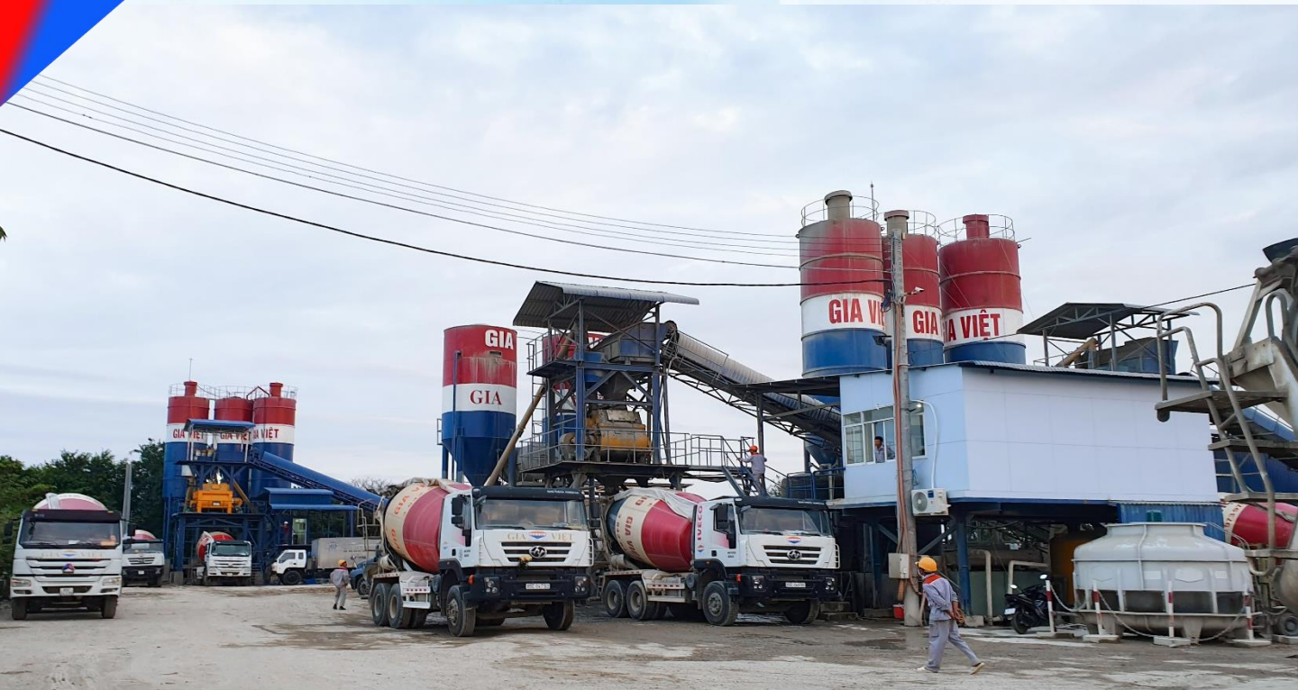
Hệ thống trộn bê tông/ Concrete mixing system
